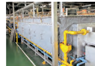
断熱ジャケットを装着したロウ付け炉
